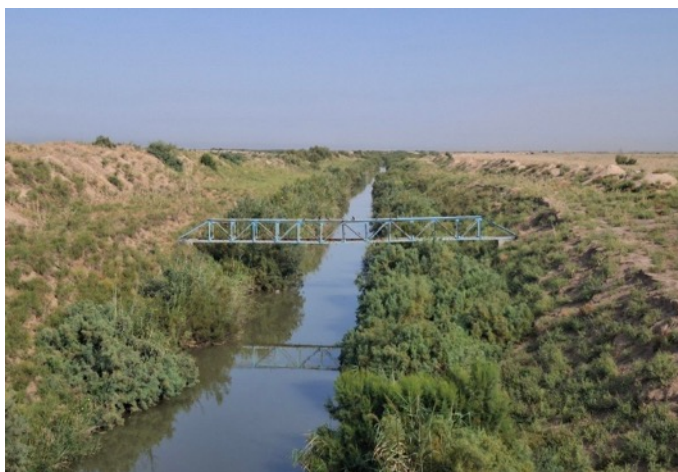
Коллектор Акбулак «Мост»
