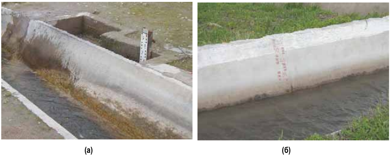
Рис. 3.5. Градуированный параболический лоток: а) с успокоительным колодцем и уровнемерной рейкой; б) с расходомерной шкалой на откосе лотка
