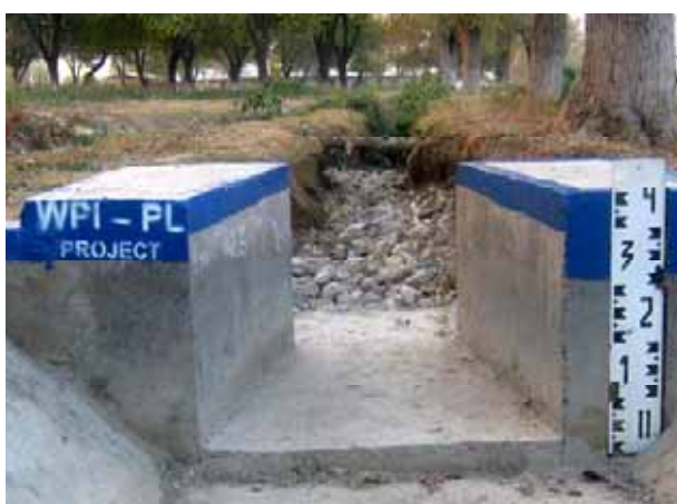
Рис. 3.3 Водомерный лоток САНИИРИ, подводящая часть 1 – входные открылки, 2- гидротехническая рейка
