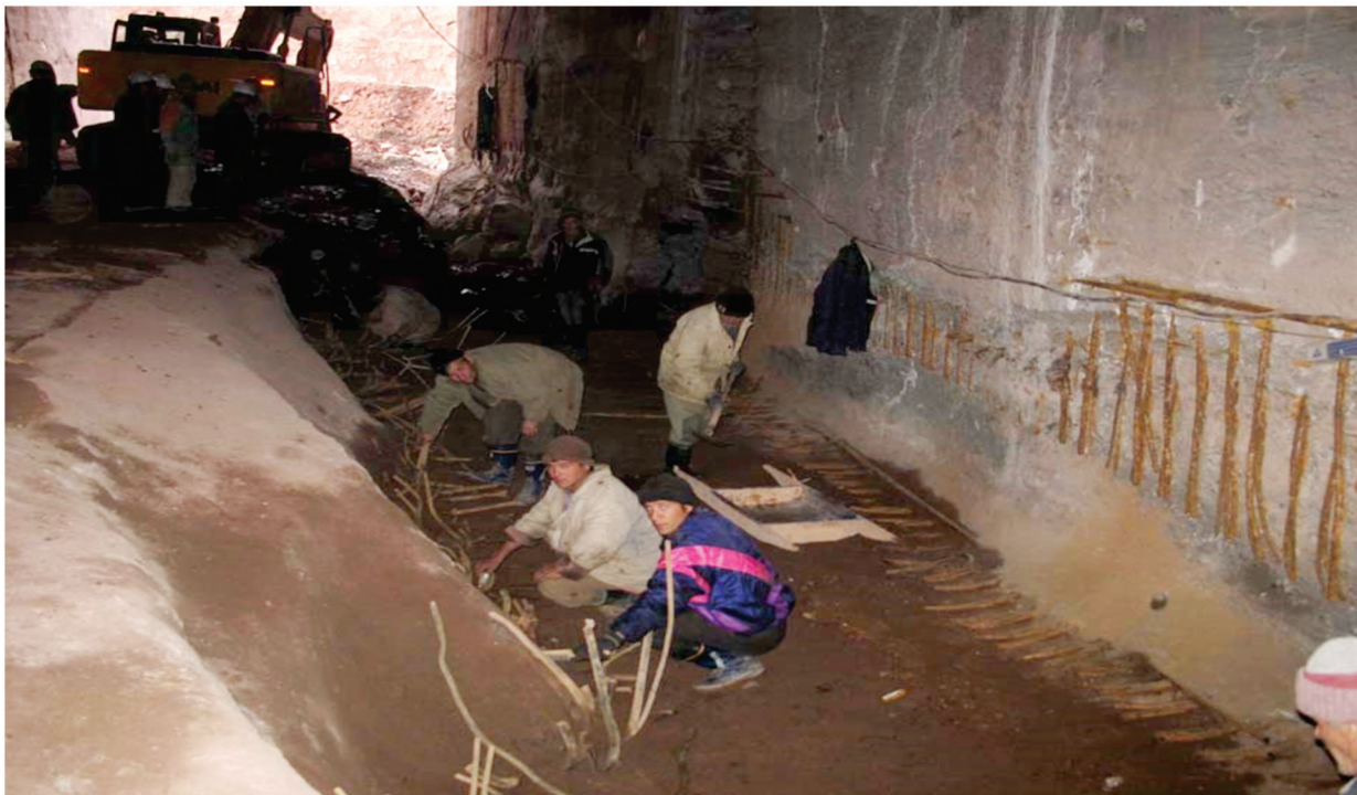
Рисунок 1. Размыв лотка I-го строительного туннеля
