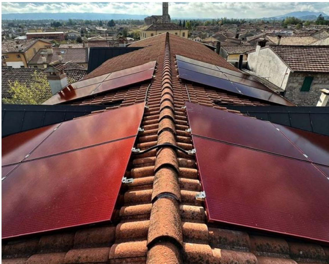
Красные солнечные панели FuturaSun
