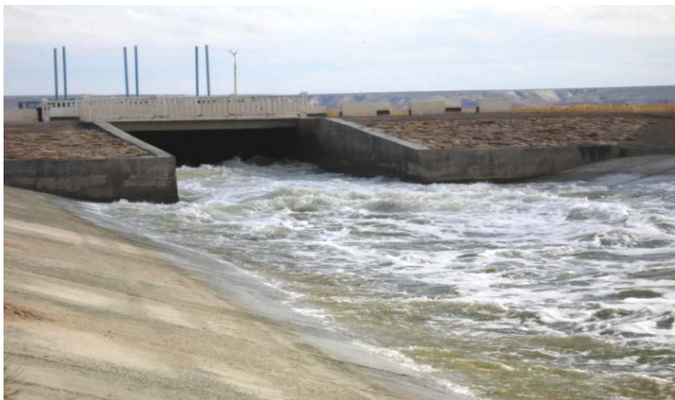
Озеро Судочье. Водовыпуск Аккумской дамбы на 55 м 3 /с (верхний и нижний бьеф)
