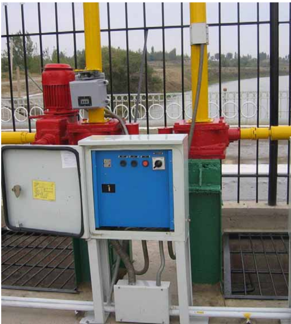
Рис. 5. Шкаф управления затворами
