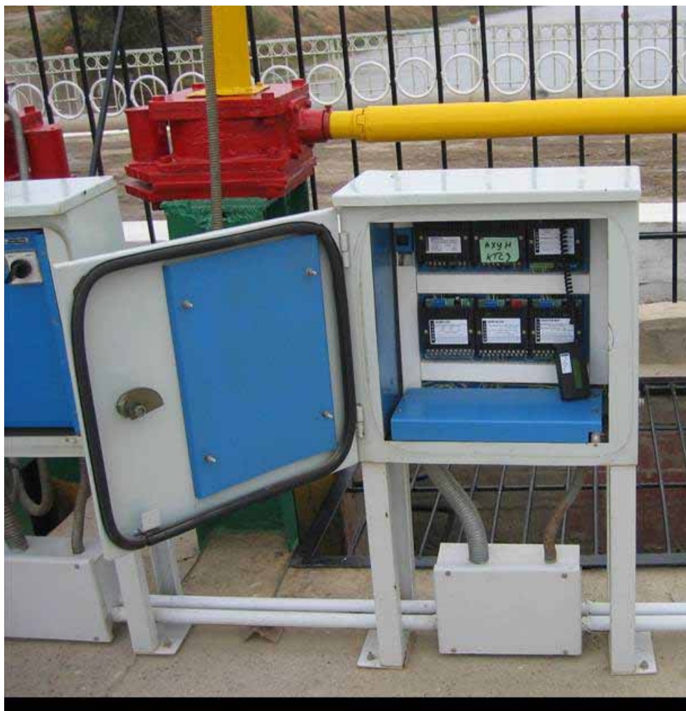
Рис. 6. Шкаф модулей контроллера
