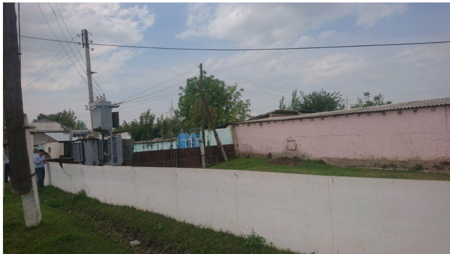
Фото с места посещения объектов проекта, на которой изображены трансформатор и столб, незаконно находясь в пределах стены частного домовладельца.
