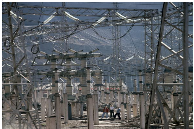
ж – открытое распределительной устройство ОРУ-500
