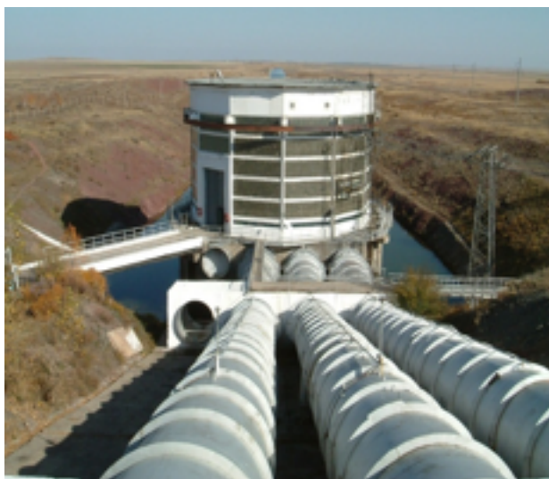
Насосная станция на канале Иртыш-Караганда имени К.И.Сатпаева
