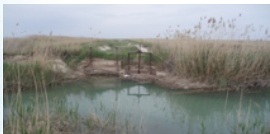
Фрагмент оросительной системы без надлежащего выполнения ЭиТС
