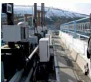
Датчик положения затворов на Кампирраватском гидроузле
