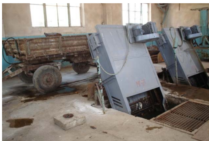
Рисунок 3.3. Мусоросборник на очистных сооружениях в Фергане, Узбекистан
