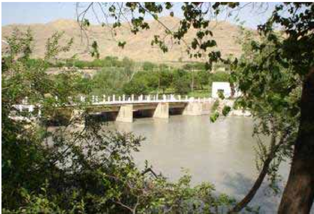
Рис. 2. Головное сооружение канала Ходжабакирган
