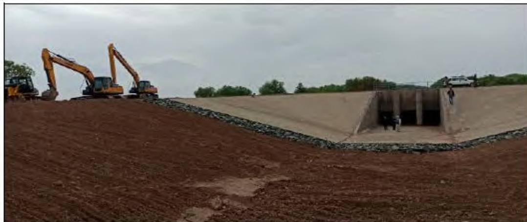
Канал Талдык вход в дюкер
