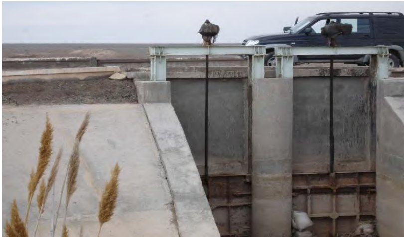
Муйнакский залив. Водовыпуск-водосброс на 10\text{ м}^3/\text{с} ПК70 западной дамбы. Год ввода в эксплуатацию 2003г. Стоимость объекта 67695,0 т.с.
