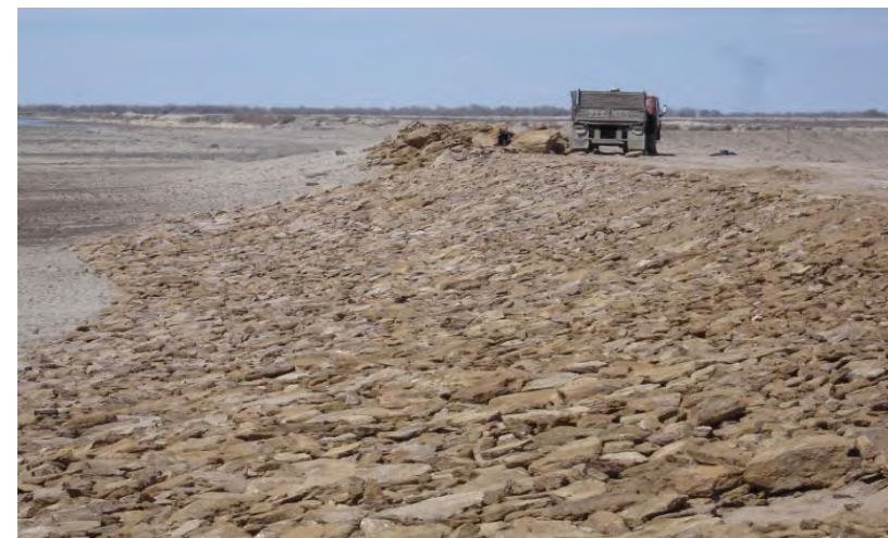
На фото: Междуреченское водохранилище. Северная дамба - укрепление каменным набросом верхового откоса дамбы.
