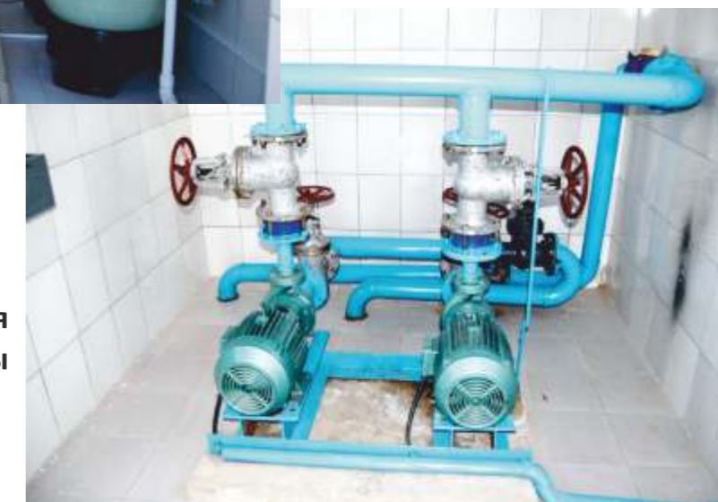
Насосные установки для подачи воды
