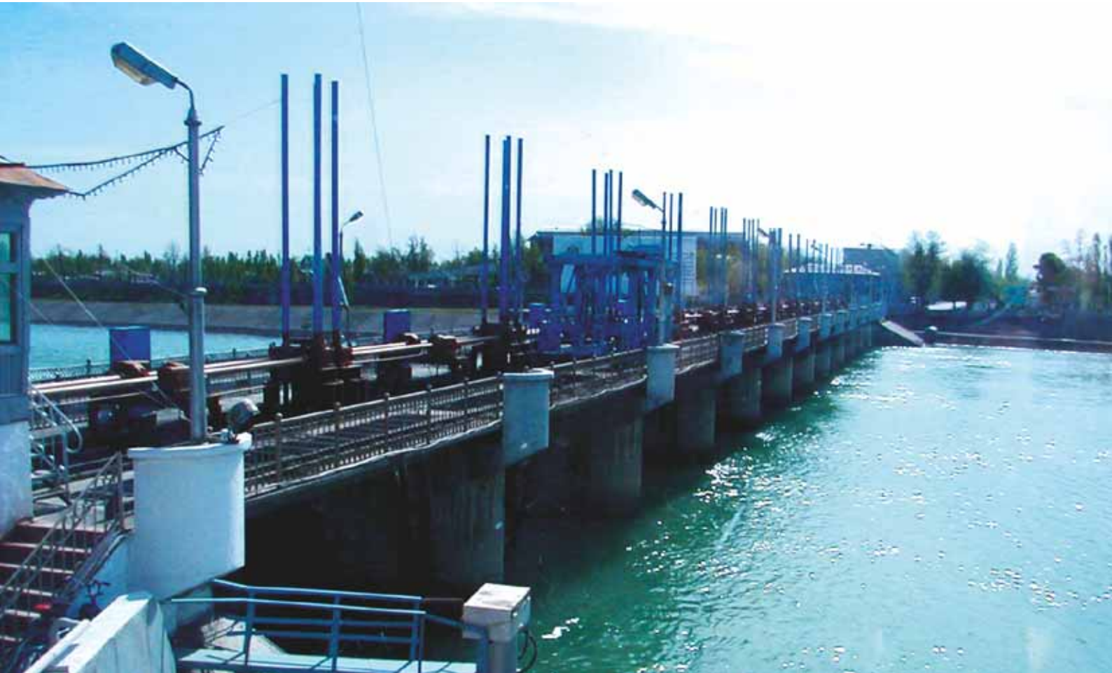
Учкурганский гидроузел (оснащенный SCADA) Uchkurgan weir (equipped SCADA)
