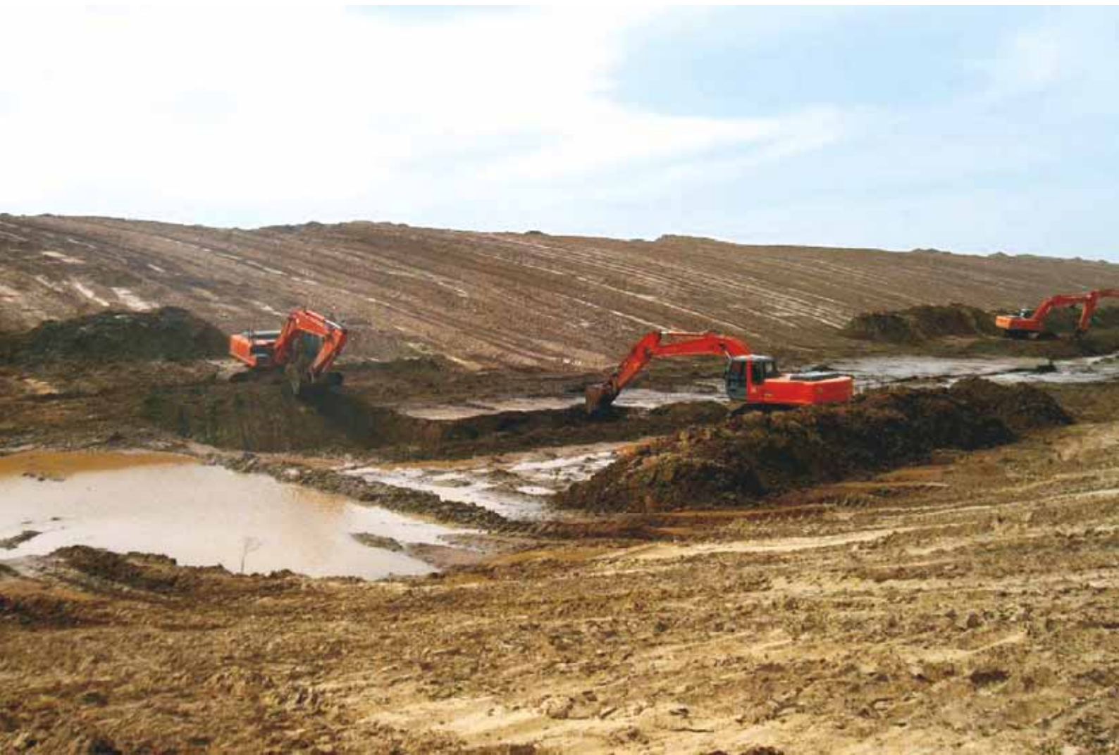
Строительство Главного Южного коллектора в Каракалпакстане Construction of the Main South Collector in Karakalpakstan
