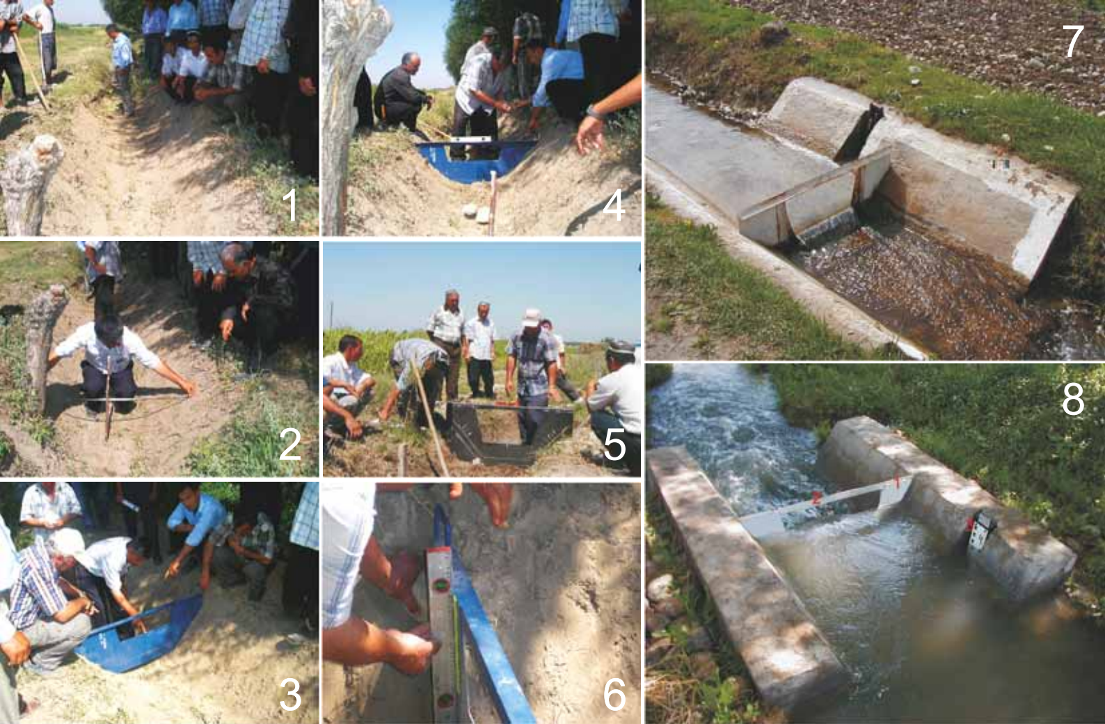
Порядок строительства гидропоста с “водосливом Чиполлетти” Construction of gauging station with “Cipolletti weir”
