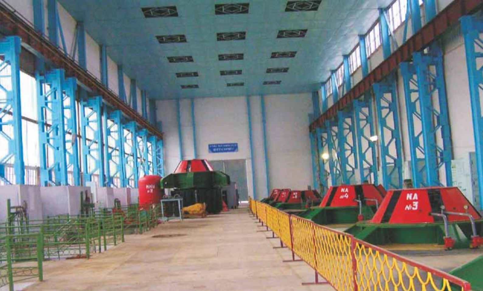
Машинный зал насосной станции Бабатаг A pumping hall of the Babatag Pumping Station
