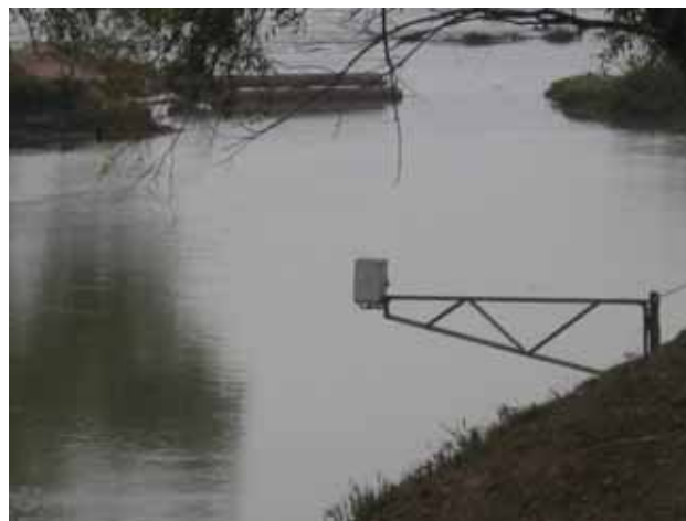
Рис. 4. Установка датчика уровня воды
