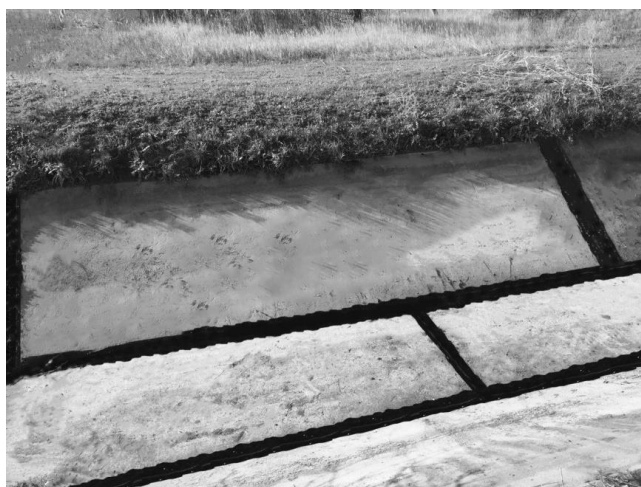
Рисунок 3 – Апробация технологии ремонта бетонной облицовки композитами в натуральных условиях (автор фото А. Ю. Гарбуз)
