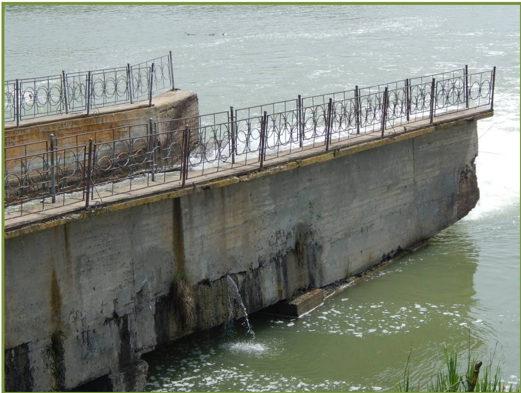
Рисунок 6 – Лоток консольного перепада (автор фото А. В. Акопян)
