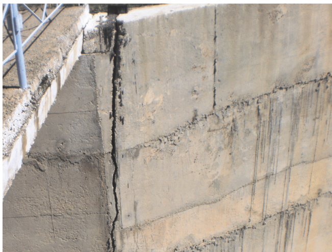
2- Расм. Зомин сув омборидаги фавқулдда сув ташлагич иншоотининг кириш қисми ён деворларида ёриқлар пайдо бўлиши
