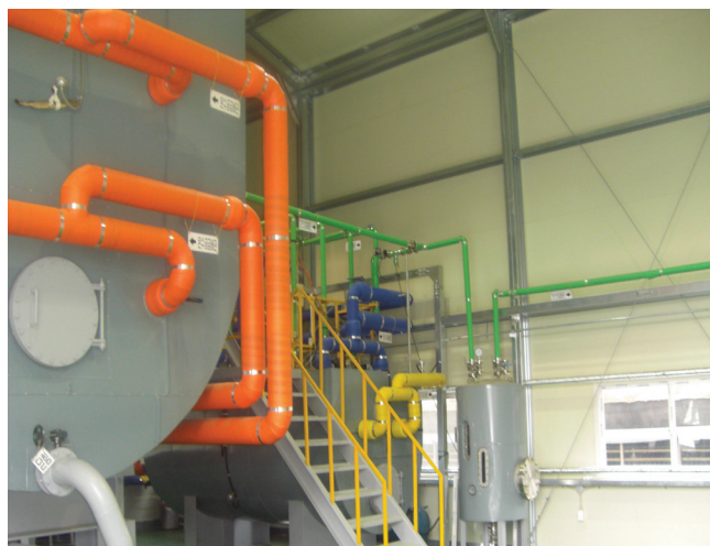
Рис.4.Биогазовая установка в Южной Кореи (рабочий объем 50000 л)
