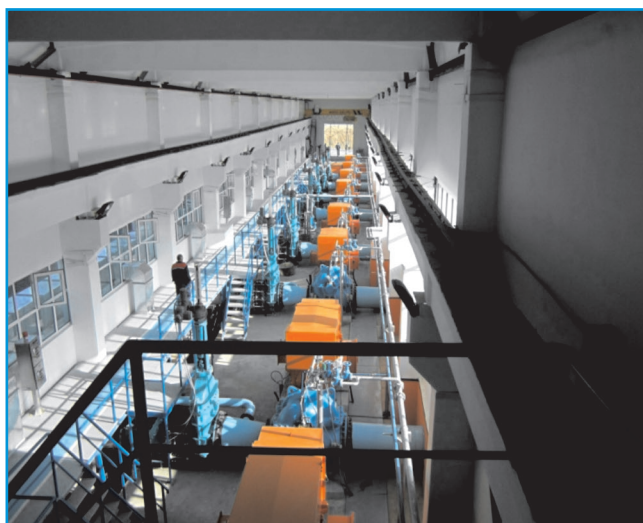
2-расм. “Булоқбоши” насос станцияси
