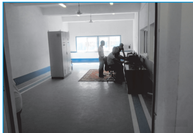
5-расм. “Қизил-равот-2” насос станцияси бошқарув хонаси
