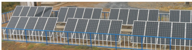
2-расм. Самарқанд вилояти “Нарпай” насос станциясида қуёш фотоэлектрик қурилмаси панелларини жойлашуви
