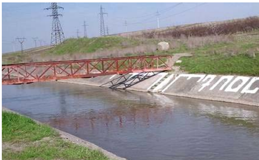
Рис.1. Гидрометрический пост типа «ФР» оборудованный гидрометрическим мостиком
