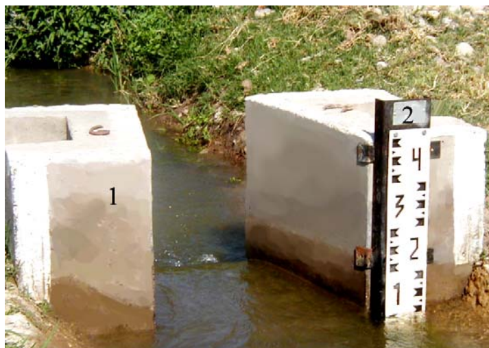
Рис. 3. Водомерный лоток САНИИРИ, подводящая часть 1 – входные открылки, 2- гидротехническая рейка
