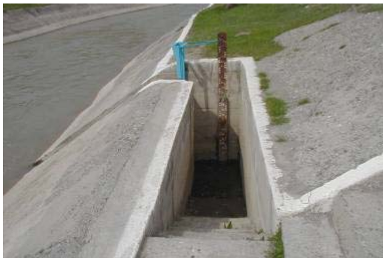
Рис.2. Успокоительный колодец с гидротехнической рейкой.
