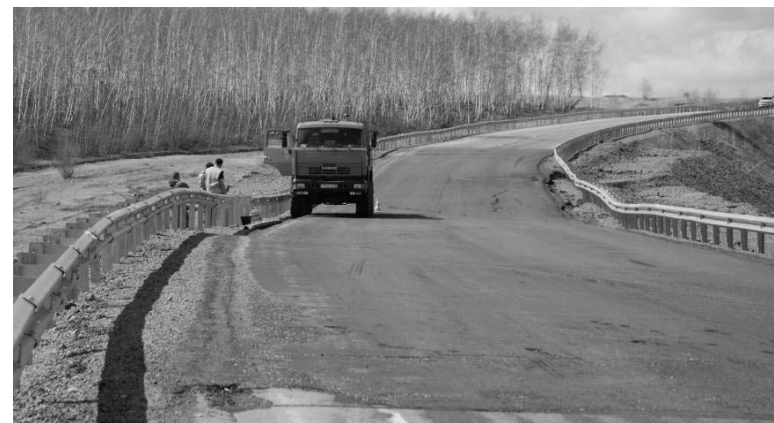
Рисунок. Деформации федеральной автодороги «Амур» Чита-Хабаровск, км 247, вследствие оттаивания льдистых многолетнемерзлых грунтов в основании, апрель 2012 г.
