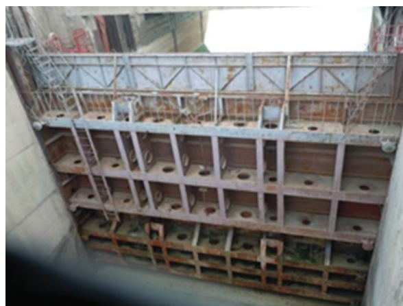
Рис. 5. Коррозия шандорных затворов Кайраккумской ГЭС
