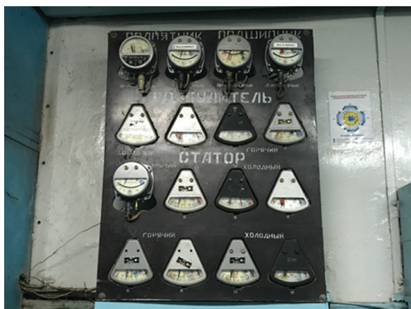
Рис. 4. Действующая система контроля и безопасности основного рабочего оборудования Кайраккумской ГЭС
