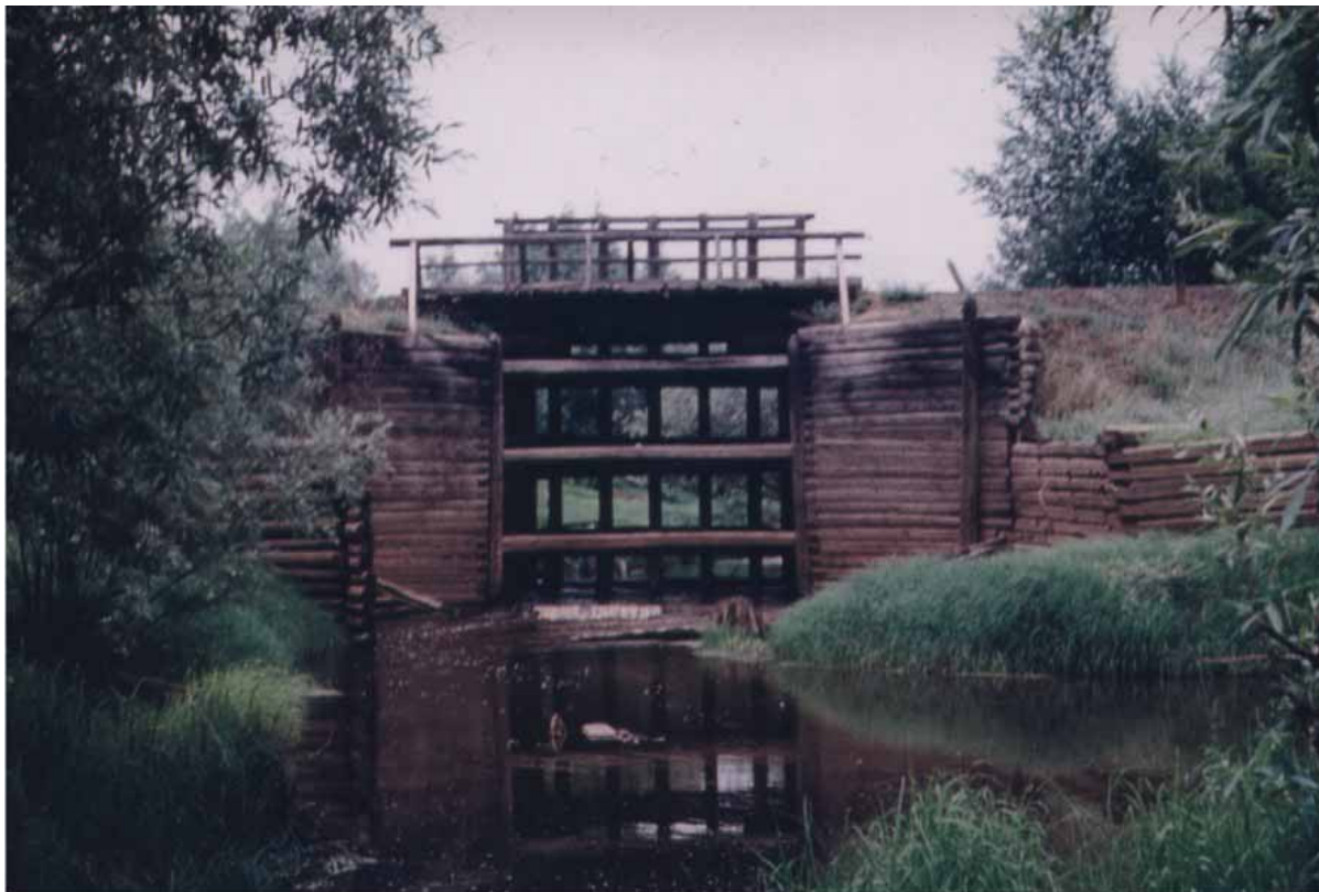
Мелиоративная система в бывшем колхозе им. Байкалова в Мегино-Кангаласском улусе РС(Я). Деревянный ряжевый водосброс, построенный в 1936 г. инженером А. Шестаковым. Система работала более 50 лет, была искусственно разрушена в 1986 г.
