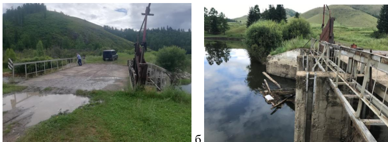
Рисунок 1 – Дефекты основных элементов гидроузла:
