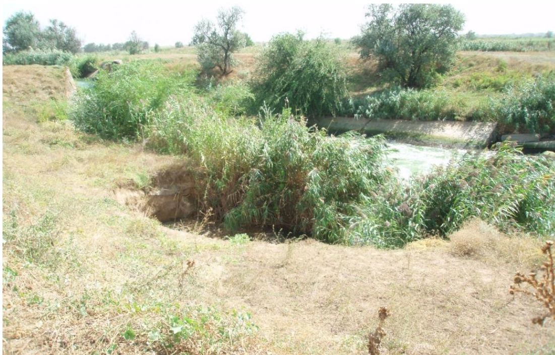
Рисунок 3.10 – Деформации берегов Пролетарского магистрального канала
