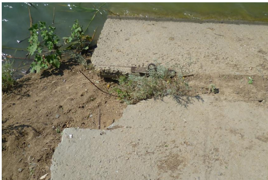
Рисунок 3.12 – Разрушение и сползание плит облицовки на Пролетарском магистральном канале
