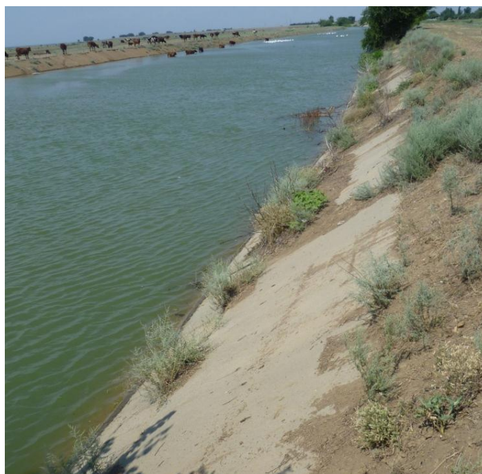
Рисунок 3.13 – Обрастание плит облицовки растительностью
