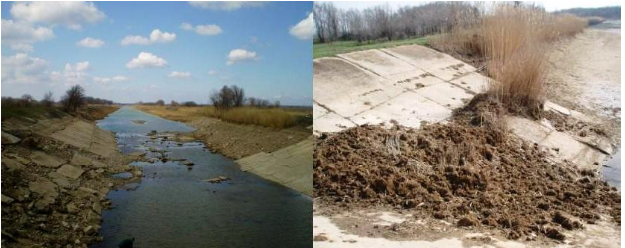
Рисунок 3.9 – Разрушение плит облицовки на ДМК
