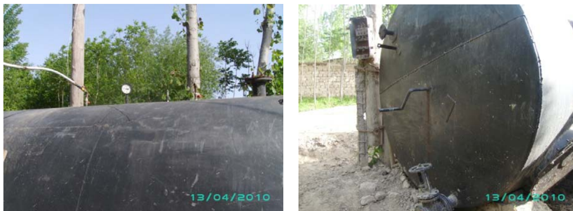
Фото 1. Биогазовая установка во дворе кооператива «Кобилчон».
