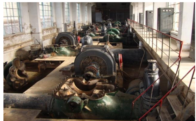
Каскад из пяти насосных станций обеспечивает подачу воды к пахотным землям в районе Гараути
