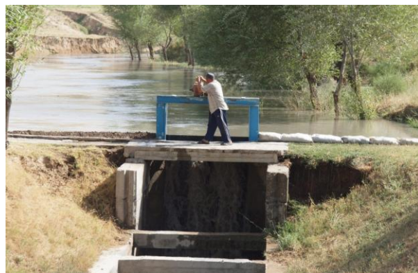
Головное водозаборное сооружение на канале Бад Бад
