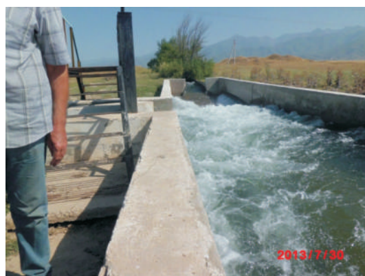
Водораспределительное сооружение на Аспаринском подпитывающем тракте
