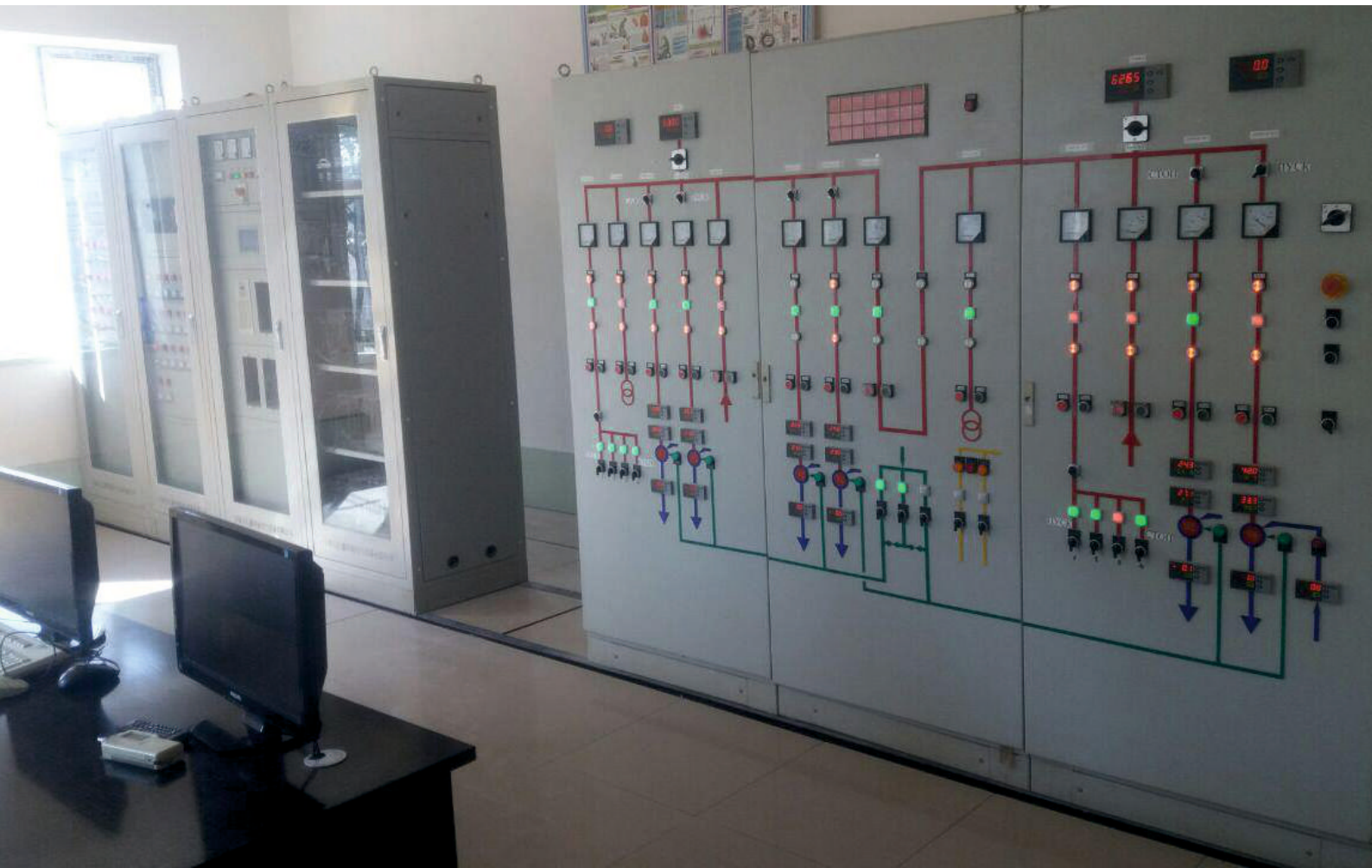
Насосная станция "Каракуль" (Бухарская область) "Karakul" Pumping Station (Bukhara Province)
