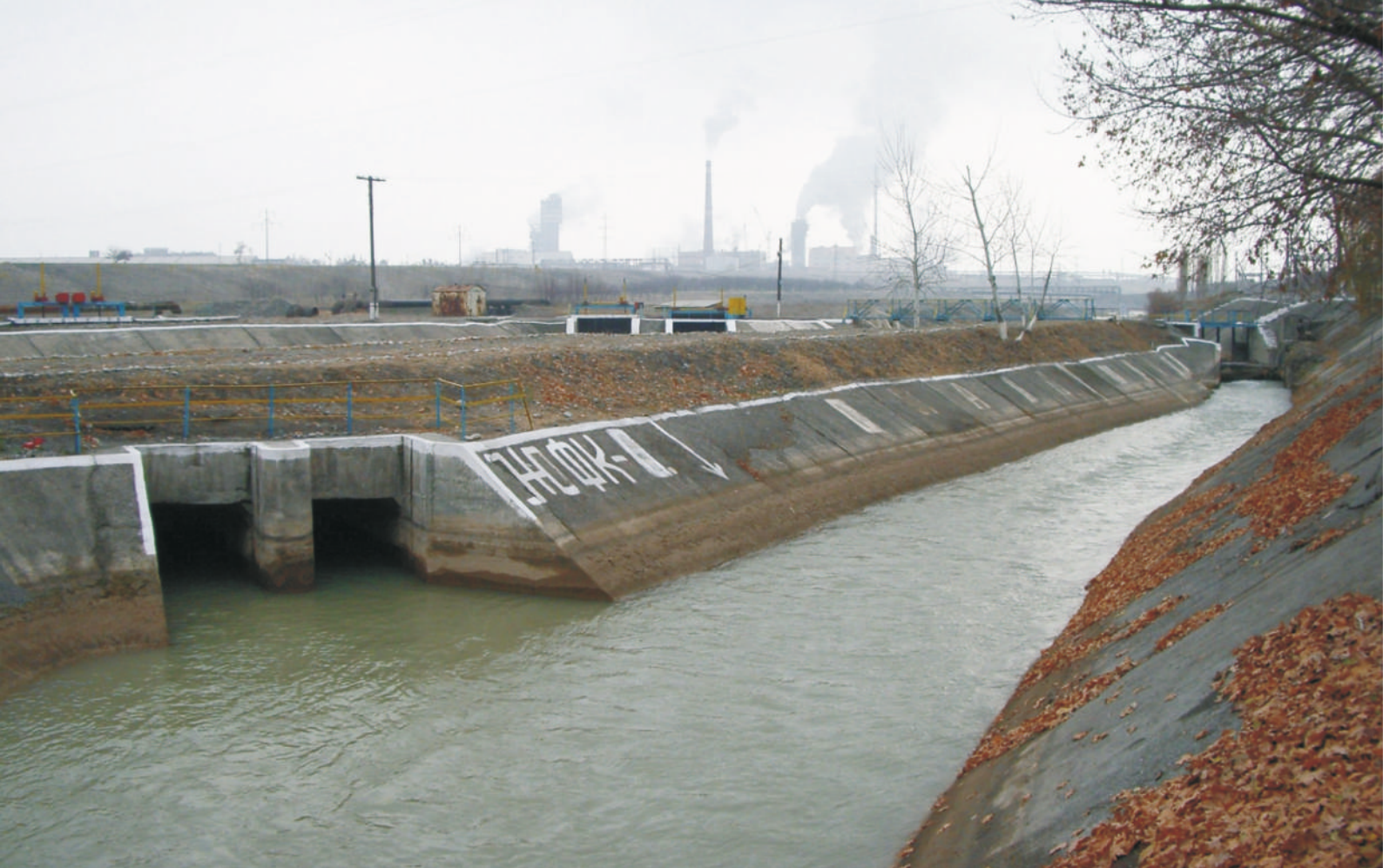
Дюкерный переход на Южно-Ферганском канале (г/у “Бешолиш”) Pipe Subway on South Ferghana Canal (Besholish)
