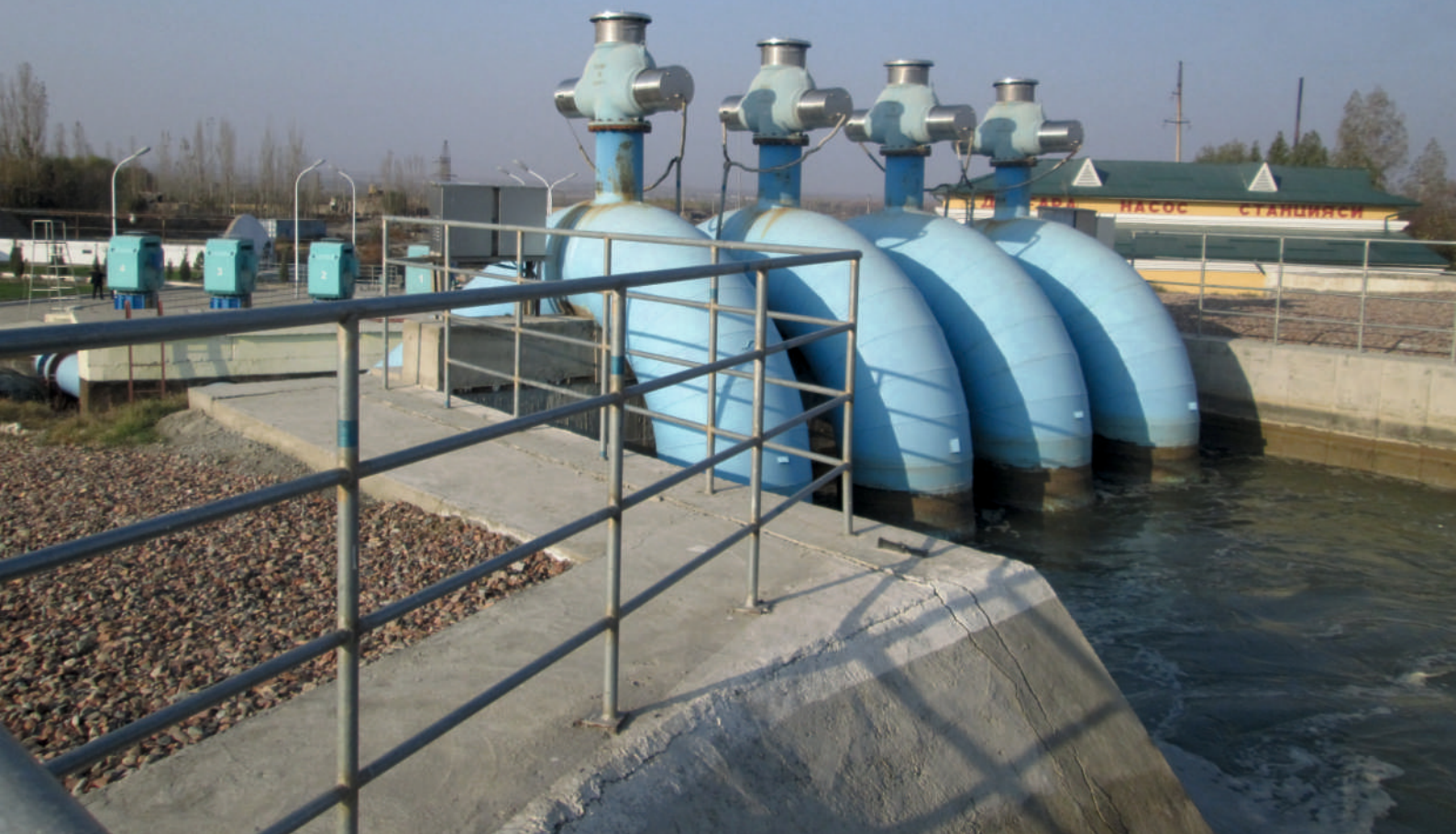
Насосная станция "Дангара" (Ферганская область) "Danghara" Pumping Station (Fergana Province)
