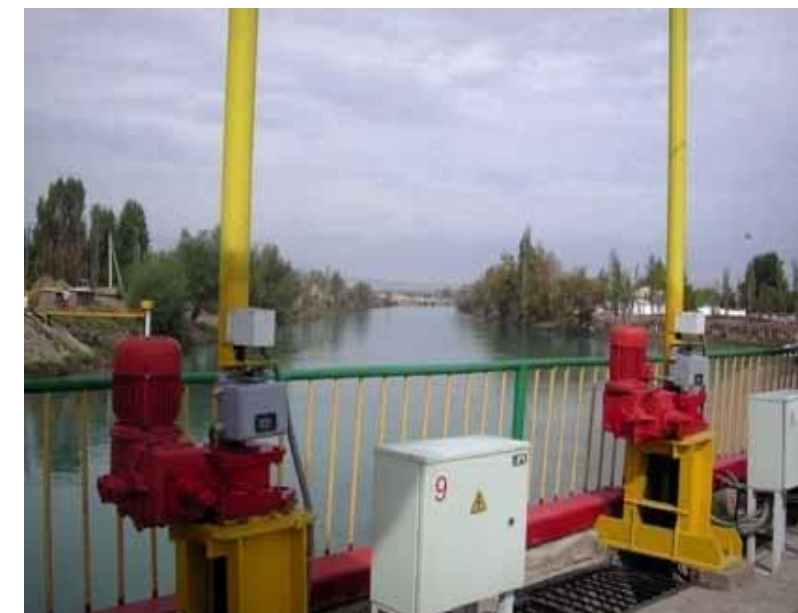
Рис 5.6 Оборудование SCADA, установленное на головном водозаборе Большого Андижанского канала
