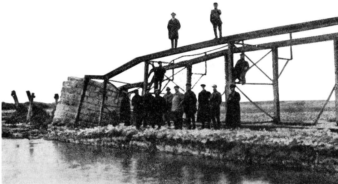
Рис. 3.6 а Вид разрушенной Раватходжинской железобетонной плотины на реке Зеравшан в 1914 году (Садыков, стр. 352)
