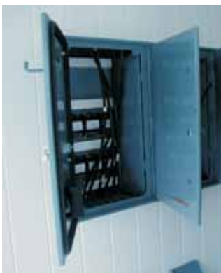
Рис. 4. Шкаф контроллеров с модулями ввода и вывода
