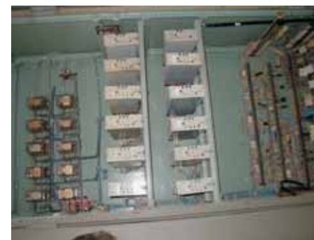
Рис. 3. Шкаф с преобразователями
