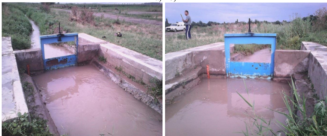
Рис 3. Водомер типа «Водослив-прямоугольный насадок» на Р-8 системы ЗБЧК (замер воды осуществляется насадком) а – вид с верхнего бьефа; б – вид с нижнего бьефа.
