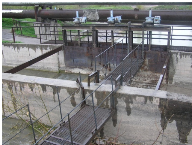
Рис.6. Водозаборное сооружение из Аламединского подпитывающего канала для резервного водоснабжения ТЭЦ г. Бишкек (А. св. СССР №1654447; Н.П. Лавров и патент КР №47; Н.П. Лавров, А.И. Рохман, У.Д. Кулибаев).
