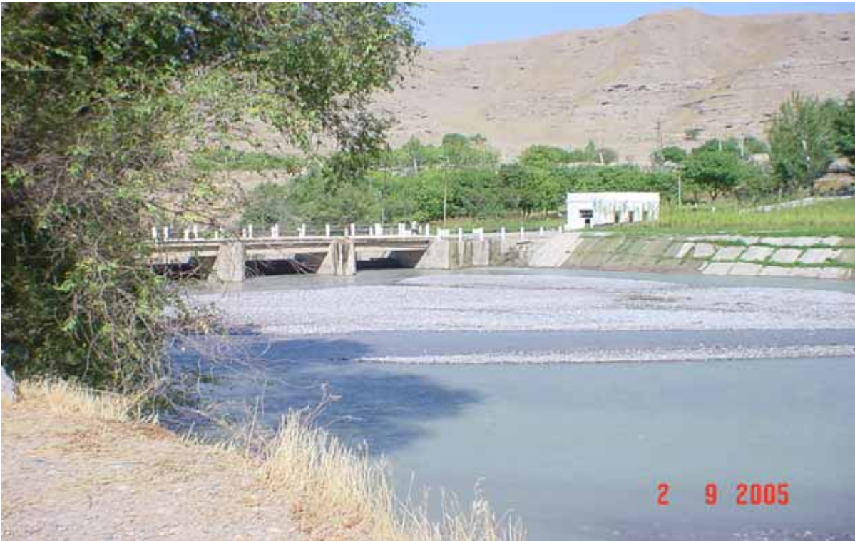
Рис 3.9. Заиление верхнего бьефа плотины
