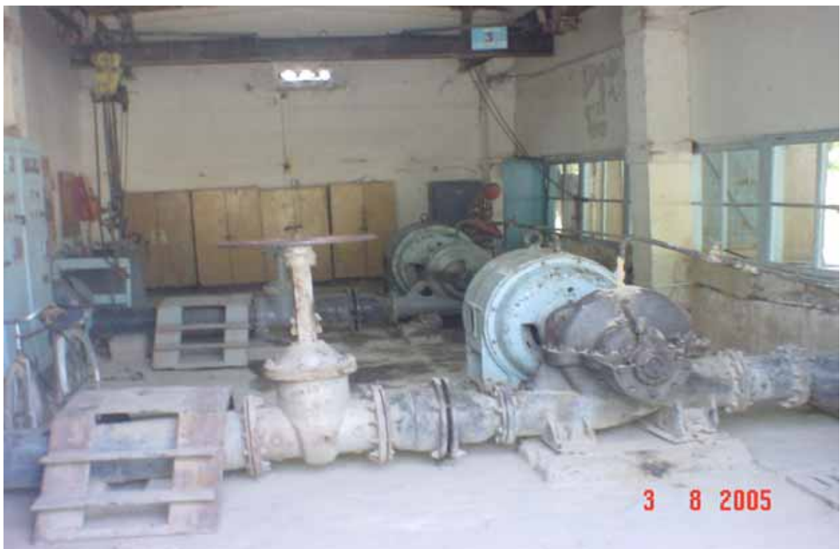
Рис. 4.6. Машинный зал насосной станции «Селькан – 0»
