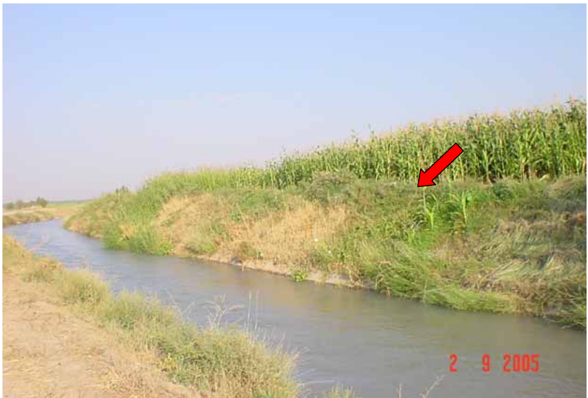
Рис.3.8. Одно из мест, где отсутствует водосборно-сбросная сеть
