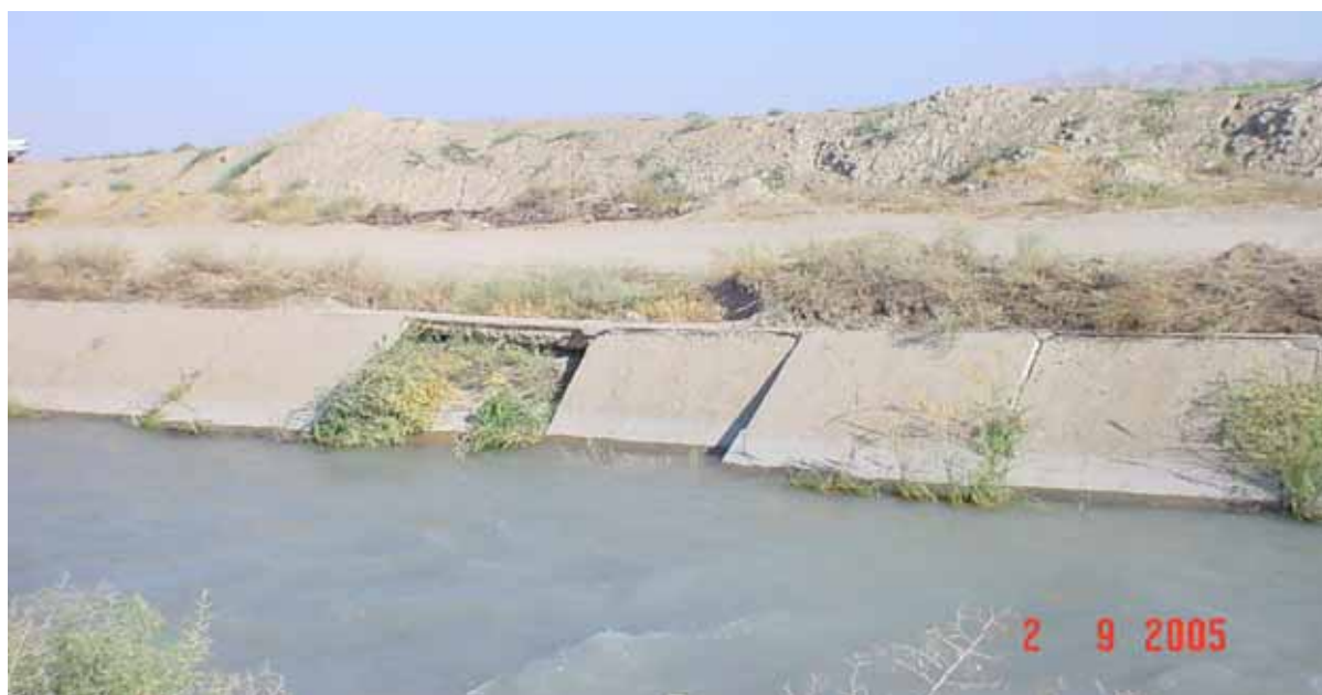
Рис 3.4. Одно из мест оползневых участков канала Ходжа-Бакирган.
