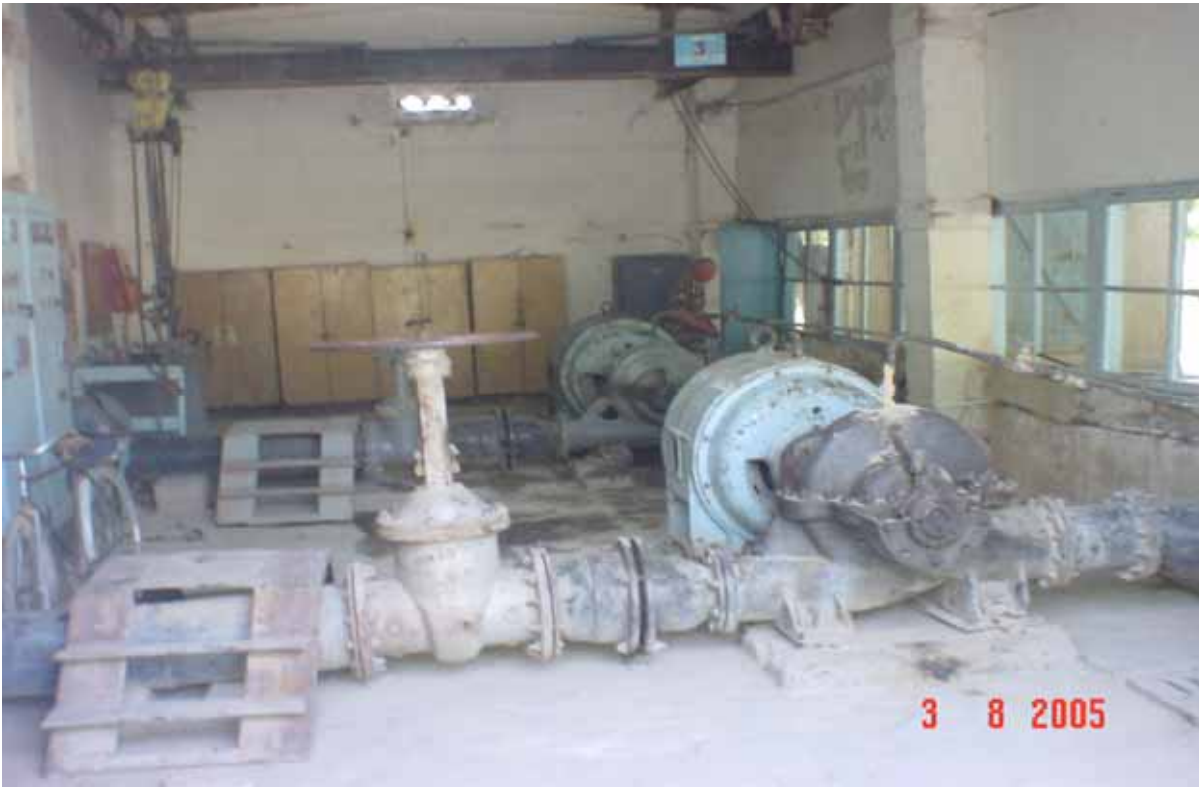
Рис. 4.9. Машинный зал насосной станции «Маданият»
