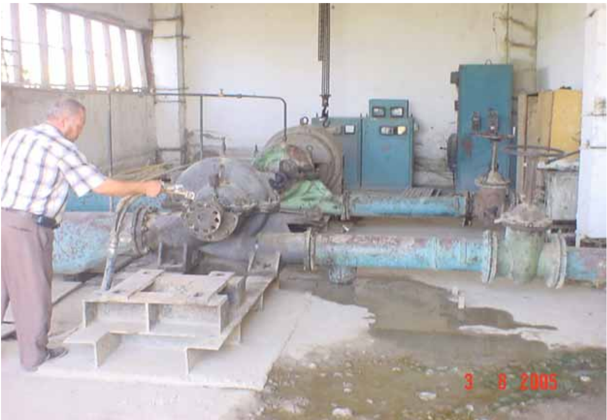
Рис. 4.8. Машинный зал насосной станции «Кара – Камар»
