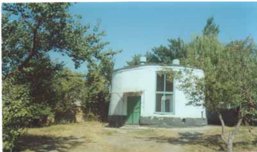
Не действующая канализационная насосная станция в ВОЗ Араван-Акбуринского канала /микрорайон «Туран» г. Ош
