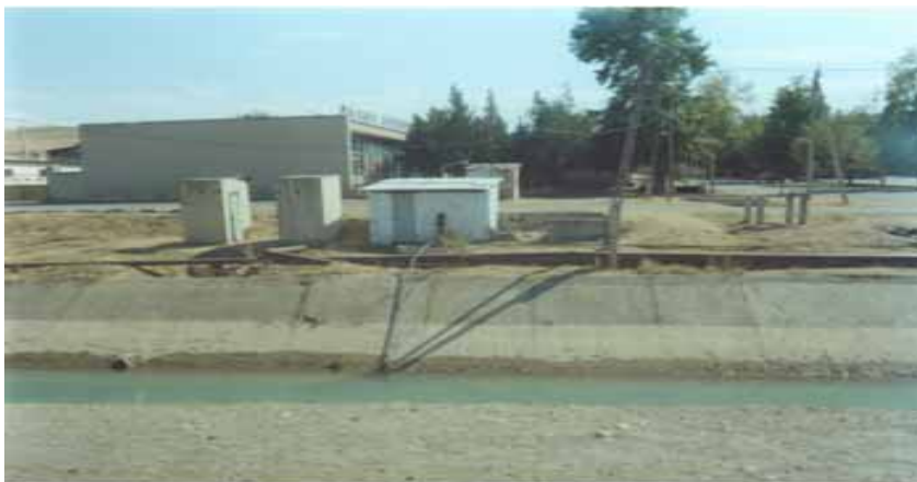
Устройство насосной станции для полива дачных участков на Араван-Акбуринском канале /подмыв берегов
