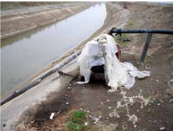
Рис. 6. Передвижной насос на ПК-860+01 ф/х «Ахмад» (г/у «Бешолиш»)
