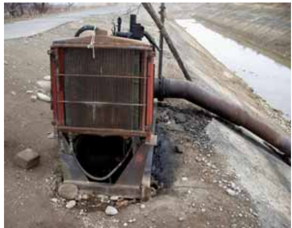
Рис. 7. Насос, установленный на ПК-877+00 ф/х «Хурмат» (г/у «Бешолиш»)
