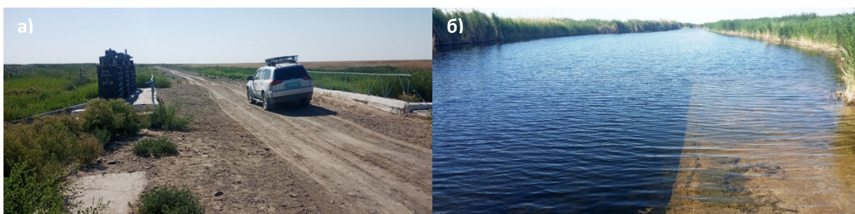
Фото 78: Точка 78. Водовыпускное сооружение (а), обильно растущие тростники в нижнем течении воды от дамбы (б).
