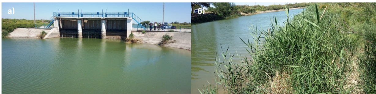
Фото 70: Точка 70. Гидроузел (а) на коллекторе КС-1 и КС-1-22 (б).
