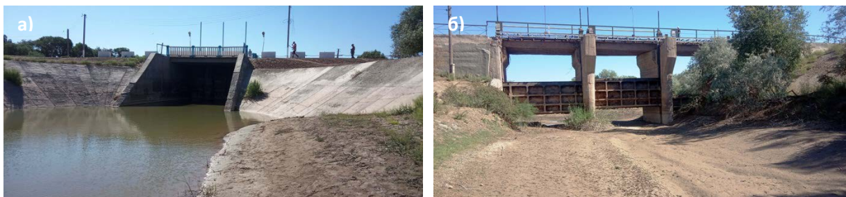
Фото 23: Точка 23. Южная часть о. Машанкуль, гидроузел им. Чапаева. Устюртский коллектор (а) и канал Каттыгар (б).
