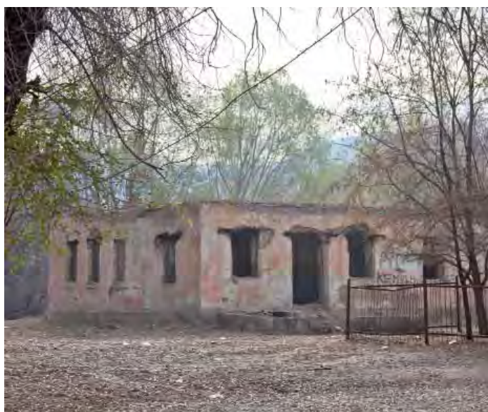
Гранитогоск. Разрушенное здание
