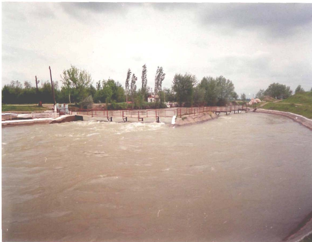
Головное сооружение ЮФМК
