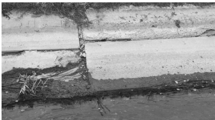
Рисунок 3 – Разрушение поверхности и оголение противофильтрационного элемента бетонной облицовки участка Багаевского распределительного канала Бг-Р-7 (автор фото А. Ю. Гарбуз)
