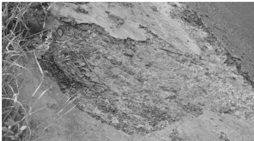
Рисунок 2 – Разрушение поверхности бетонной облицовки участка Багаевского распределительного канала Бг-Р-6 (автор фото А. Ю. Гарбуз)
