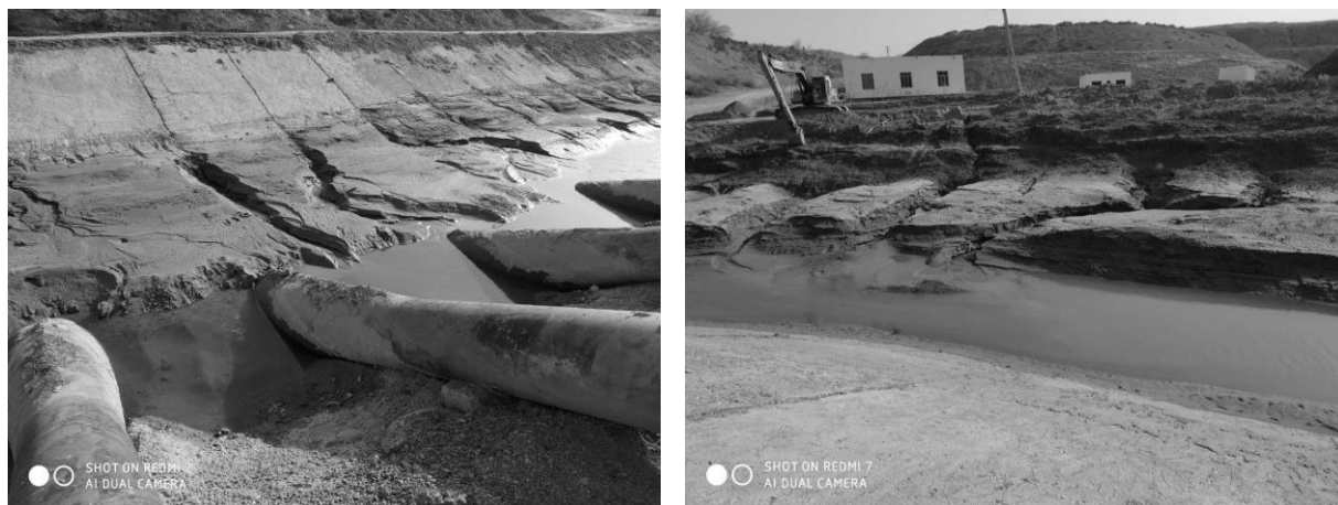
Рисунок 1 – Разрушение откосов подводящего канала насосной станции «Кизил-Тепа» (автор фото НИИИВП)
