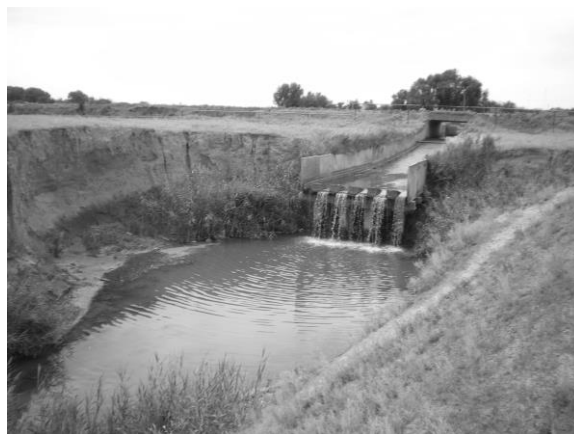
Рисунок 1 – Состояние нижнего бьефа консольного водобросного сооружения налевой ветви Право-Егорлыкского канала в Ставропольском крае
