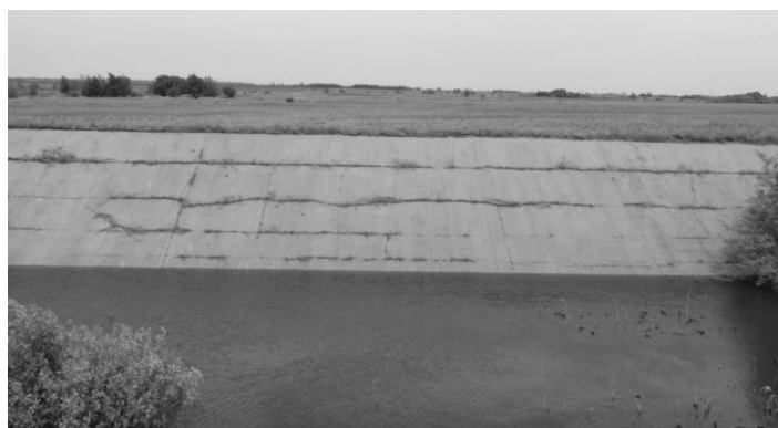
Рисунок 3 – Образование продольных трещин в бетонной облицовке магистрального канала КООС, 2018 г.
