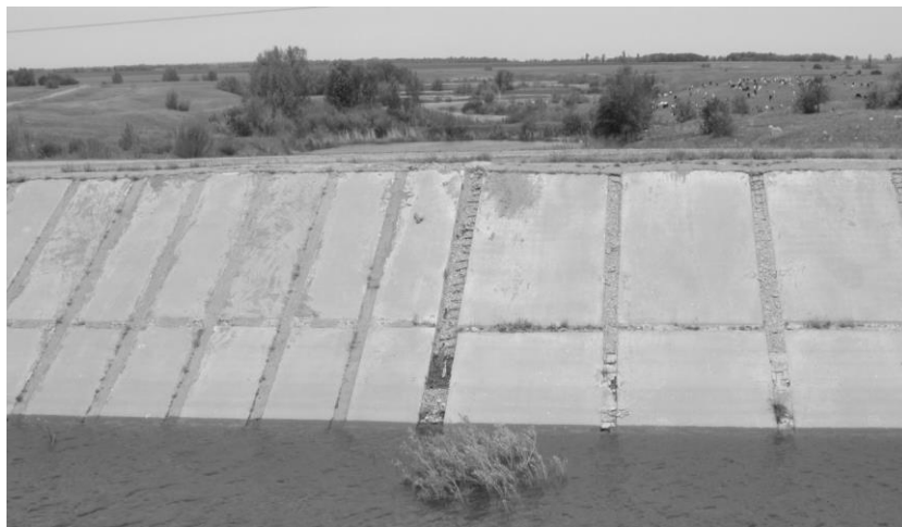
Рисунок 1 – Состояние межплитных швов и облицовки канала на первом участке, 2018 г.
