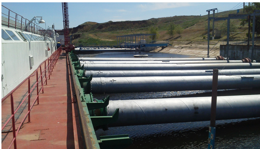
Рисунок 2 – Головная насосная станция (автор фото С. М. Васильев)
