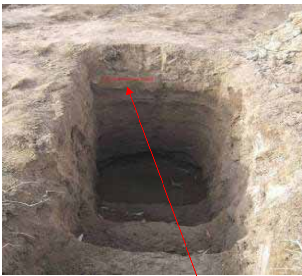
Фото 2.3 Уплотненная зона почвы
