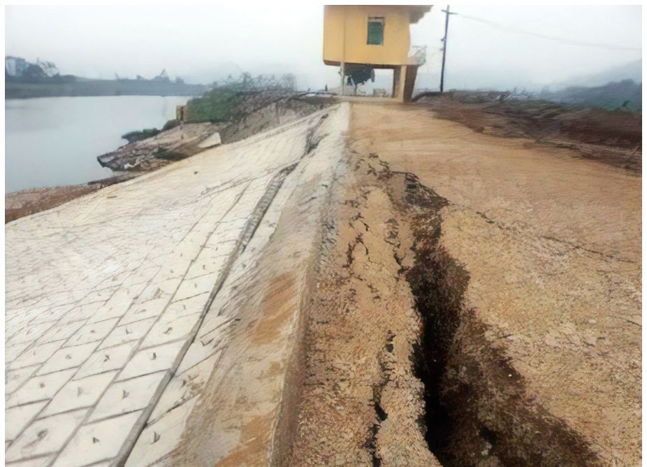
Рис. 4. Трещины в теле дамбы (фото Т.Х. Динь)
