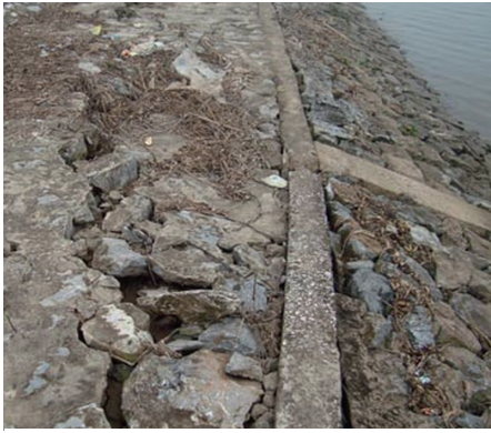
Рис. 5. Нарушения устойчивости откоса дамбы за счёт быстрой сработки уровня паводковых вод (фото Т.Х. Динь)
