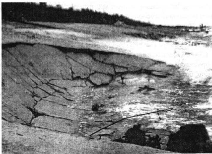
Рис.2. Монолитные ж/б плиты 25x25x0,15 м с уплотнением стыков опалубкой, фильтр сплошной двухслойный. Высота волн 3,2 м, расчетная 3,0 м, навал груженной баржи.
